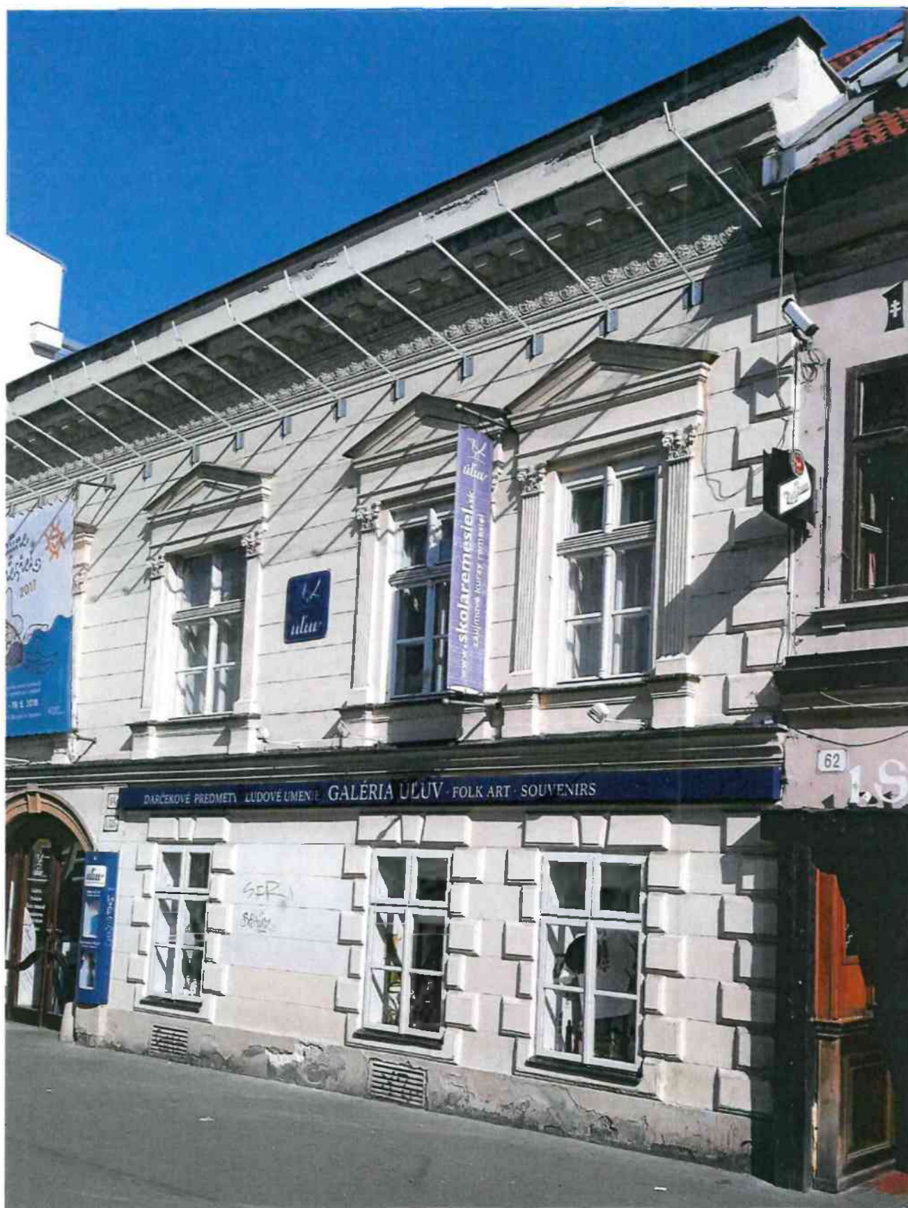
Príklad bezpečnostných sietí na fasáde domu, oceľová konštrukcia + pletivo. Bez zatienenia miestností v budove. Bratislava, Obchodná 64.
