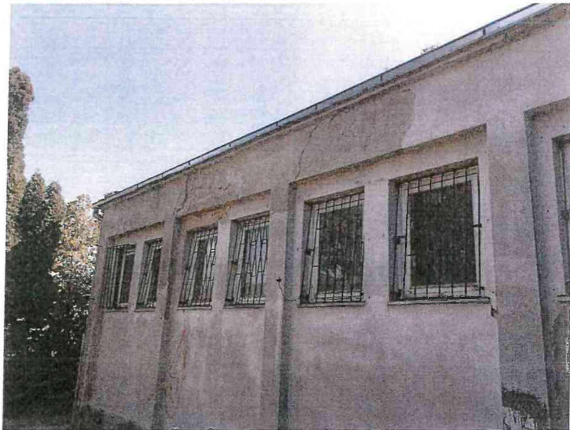
Obr.7 Pohľad na stav atiky a omietku objektu (prevlhnutý pórobetón)
