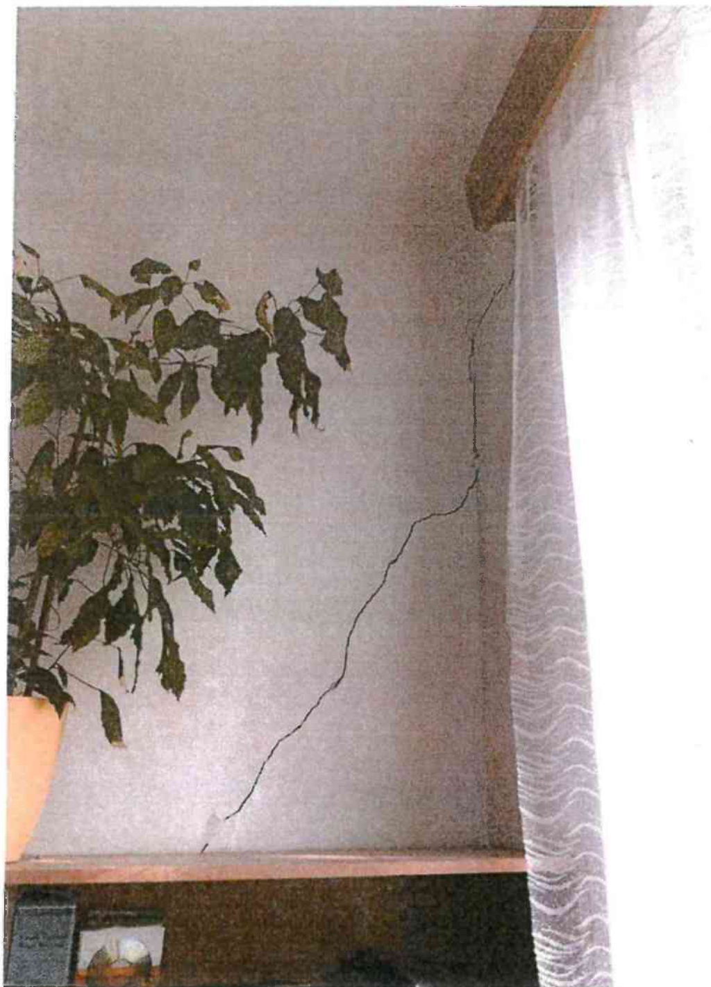
Obr.6 Trhlina na štítovej stene od Marhuľovej ulice, pohľad z interiéru
