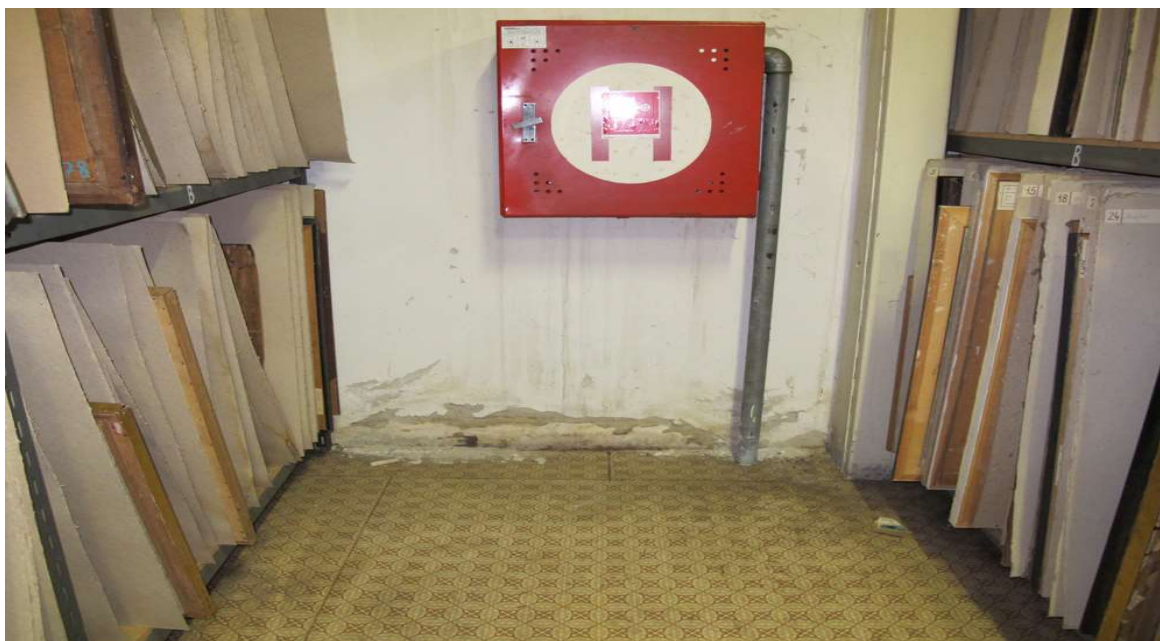
Nevyhovujúci stav uloženia zbierok
