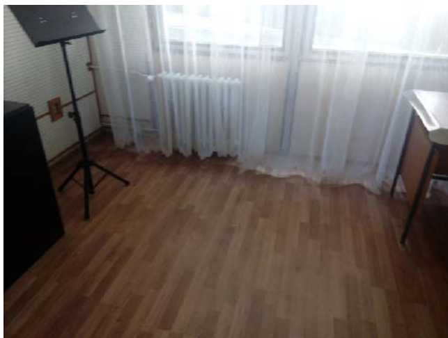
odstránenie havárie, plesne, oprava omietky a nová podlaha chodby a klavírnej miestnosti
