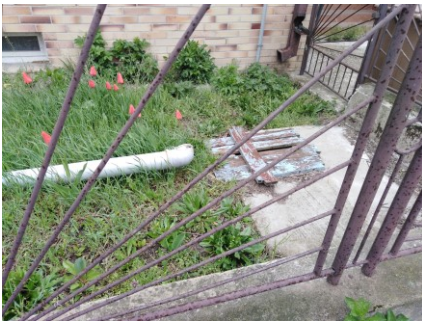
Vodomerná šachta na pozemku p.č. 518/5
