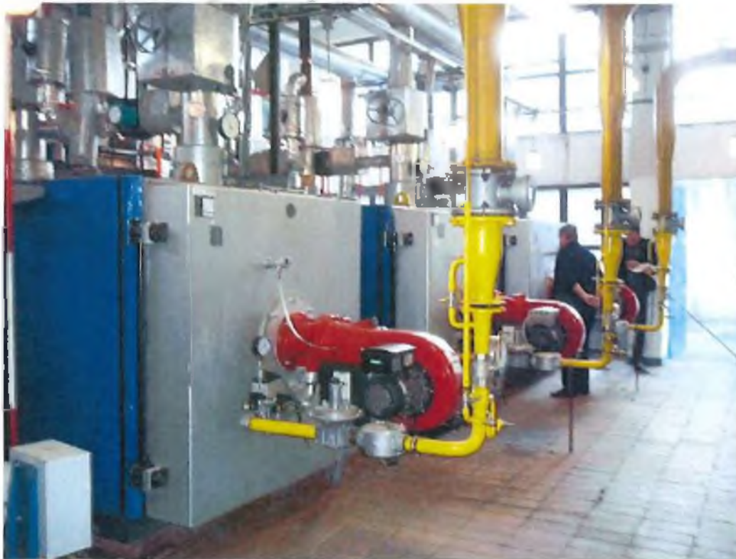
Pohľad na nízkotepotné kotle s pretlakovými horákmi v kaskáde
