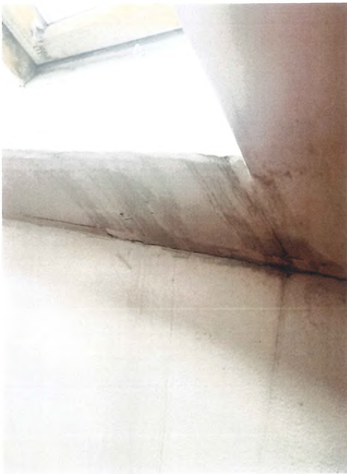
11. detaily poškodenia strešných okien a príslušenstva
