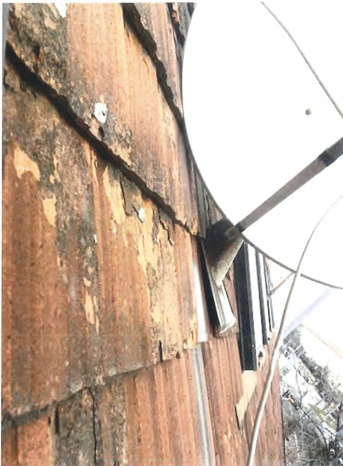
7. detaily poškodenia krytiny a príslušenstva
