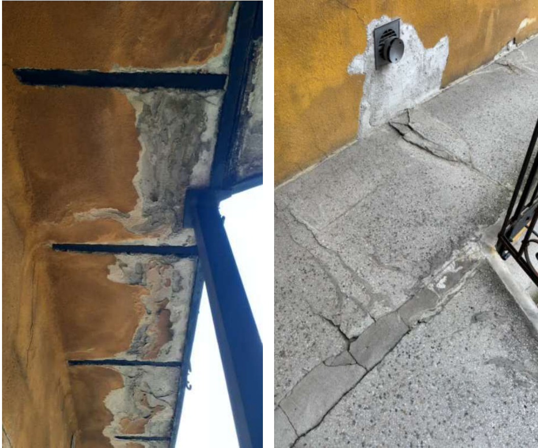
Obr.č. 23, 24 – pohľad na zatečenú konštrukciu pavlače a popraskanú podlahu
