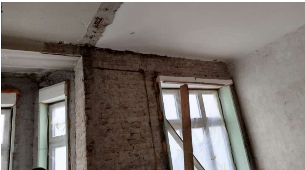
Obr.č. 12 – Poškodená obvodová stena s arkierom
