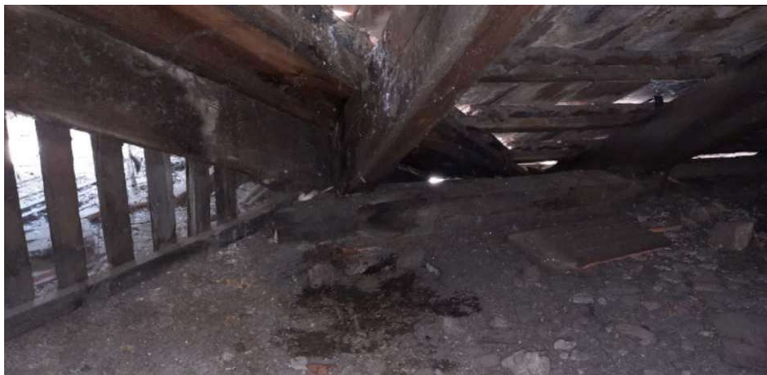
Obr.č.20 – spráchnivelá pomúrnica v nároží, spráchnivelé zhlavia krokiev
