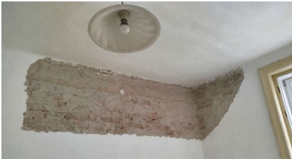
Obr.č.14 – zatečené steny, opadaná omietka pod podkrovím
