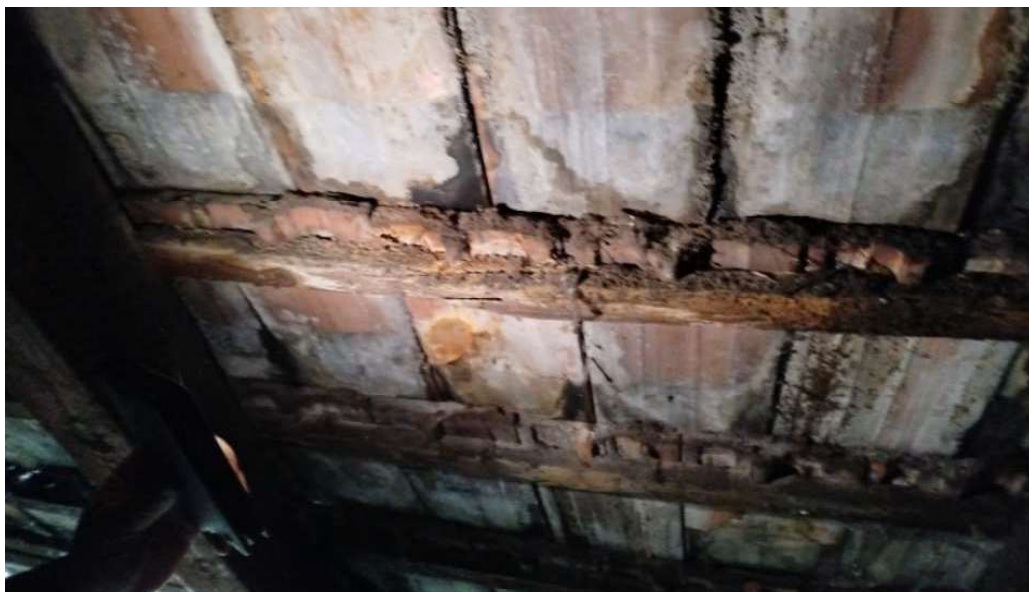
Obr.č.17 – spráchnivelé a deformované latovanie, ozuby škridiel zvetrané a rozpadnuté
