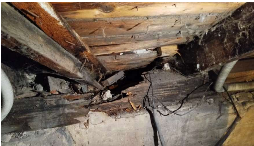
Obr.č.18 – spráchnivelé pomúrnice
