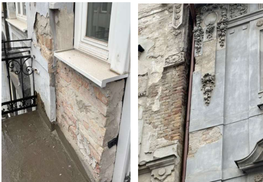
Obr.č.2, 3 – Detaily porúch uličnej fasády
