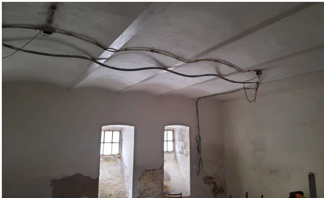
Obr.č. 8 – Strop a poškodené vlhké murivo – pivničné uličné priestory
