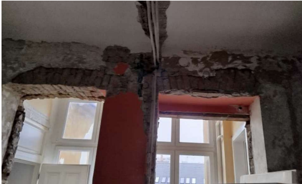
Obr.č. 11 – Poškodené murivo a nadpražie vo vstupe do bytu
