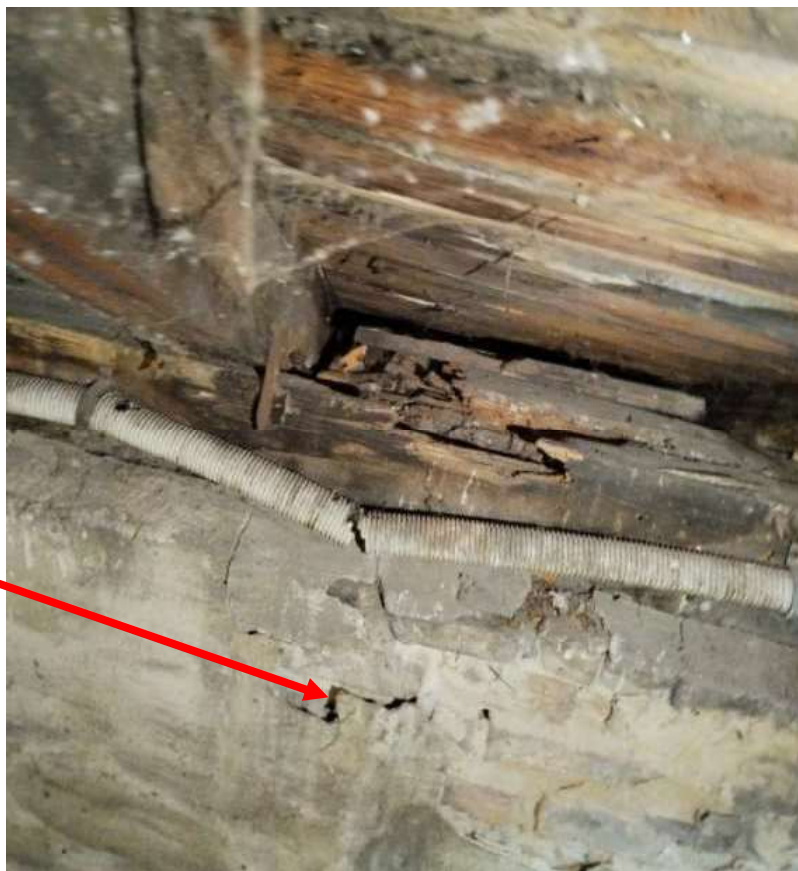
Obr.č.19 – spráchnivelá pomúrnica a rozpadnutý murovaný sokel
