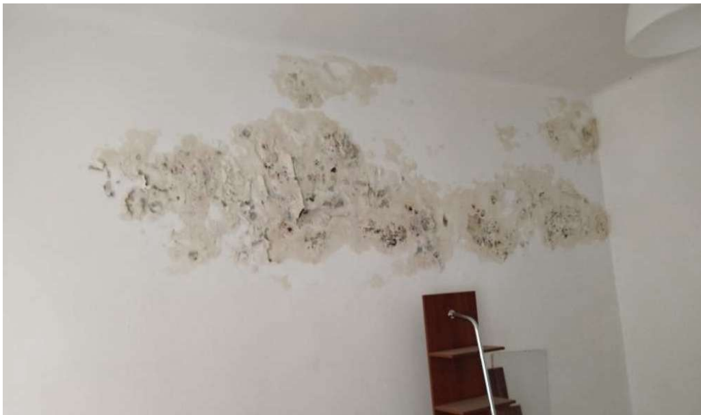
Obr.č.15 – zatečené a zavlhnuté steny napadnuté plesňou
