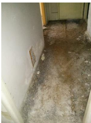
Chodba, odobraté podlahy
