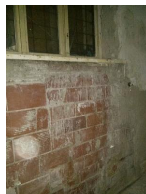
Izba, degradované omietky
