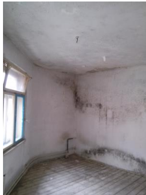
Izba, pleseň stena a strop
