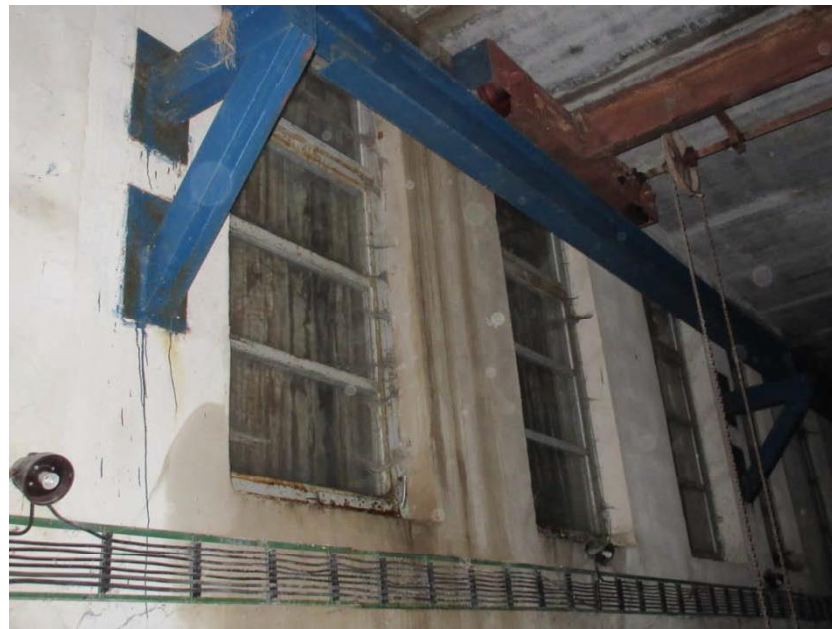
Vnútročné priestory manipulačnej komory
