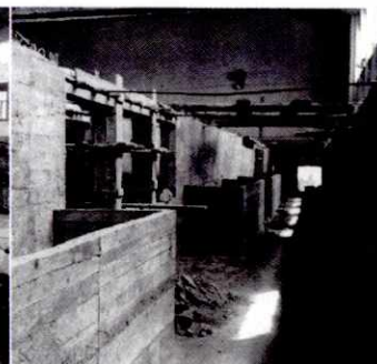
Doprava jednej z piatich nadzemných nádrží
