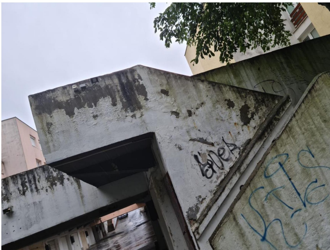
Vizuálne poruchy stenových prvkov
