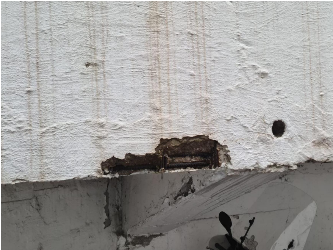
Krycia vrstva, obnažená výstuž
