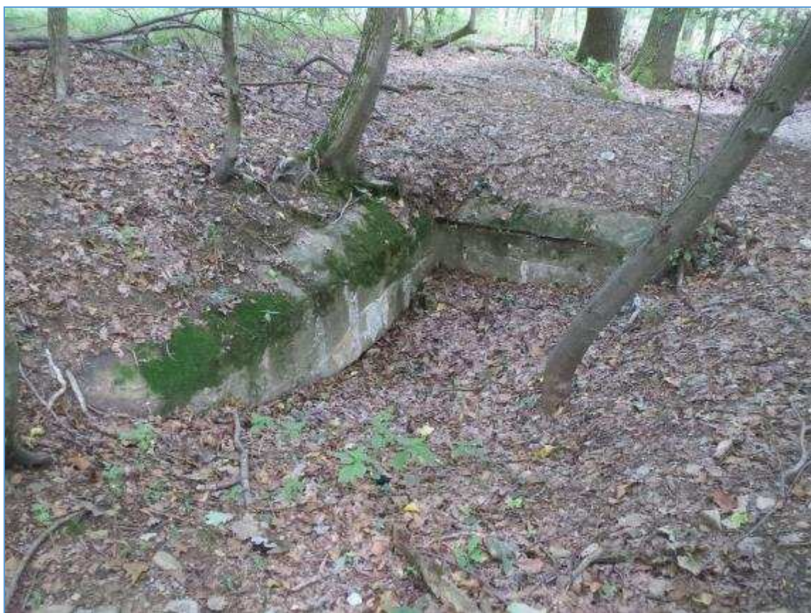
Detail betónového armovania zasypanej kaverny č.04 na Zidinách
